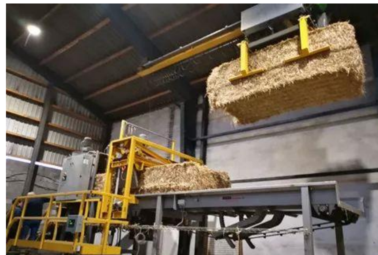
打捆直燃锅炉供暖系统
