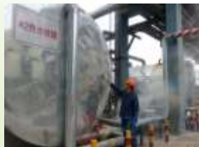
热水站 (洗浴用水)
